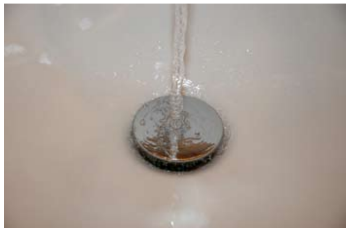
■ Eine Kleinigkeit, die verheerende Folgen haben kann: Nach dem Auswechseln der Waschtischarmatur trifft der Wasserstrahl direkt auf den Auslauf; es besteht durch hochspritzendes Wasser die Gefahr einer retrograden Kontamination vom Strahlregler in die Installation.
