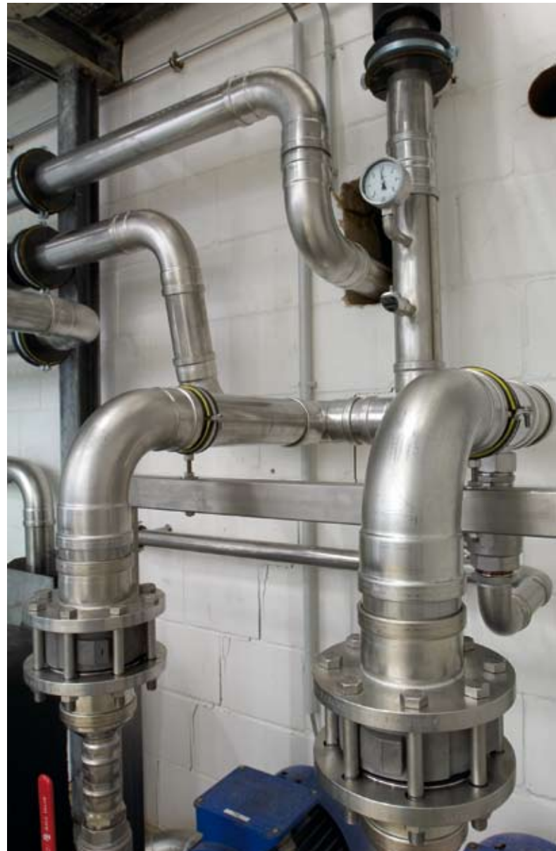
■ Dipl.-Ing. Michael Lübbert setzt bei seinen Planungen ganz konservativ auf vorbeugenden Hygieneerhalt: die Hauptverteilungen werden generell in Edelstahl oder alternativ in Kupfer, die Stockwerksverteilungen aus formstabilem Mehrschicht-Verbundrohr ausgeführt.
