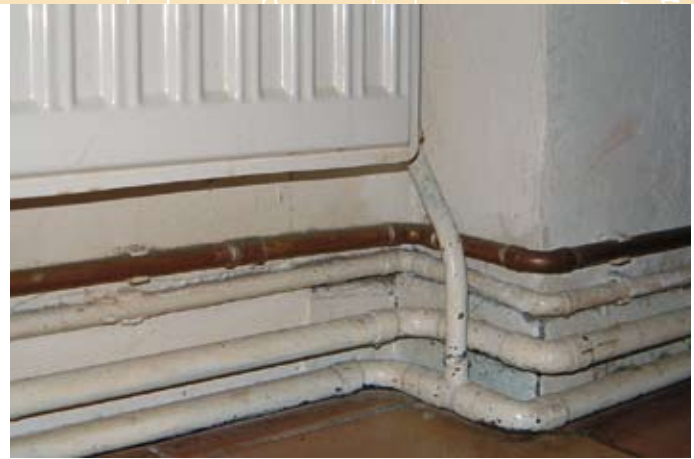
■ Eine für den Erhalt der Trinkwasserhygiene fast schön „tödliche“ Installation in einem Altbau: Die neu verlegte, knapp fünf Meter lange Stichleitung (15er-CU-Rohr) für die Kaltwasserversorgung der Zapfstelle wurde nur wenige Zentimeter über Vor- und Rücklauf der Heizkörper verlegt.
