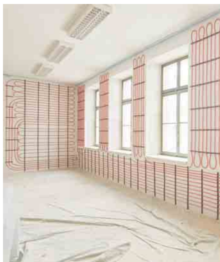
❷ Flächennutzung, wie die Normheizlastberechnung sie vorgab: Je nach Raumgröße sind die Wände der Klassenzimmer deckenhoch, manchmal sogar einschließlich Teilen der Zwischenwände mit der Fonterra-Wandheizung ausgestattet.
