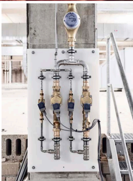
Hygiene der Marke Viega: Sämtliche Medien im Bereich der Lebensmittelverarbeitung werden bei Metten durch Edelstahlrohre geleitet. Zum Einsatz kommen anwendungsbezogen die Werkstoff-Qualitäten 1.4401 und 1.4521.
