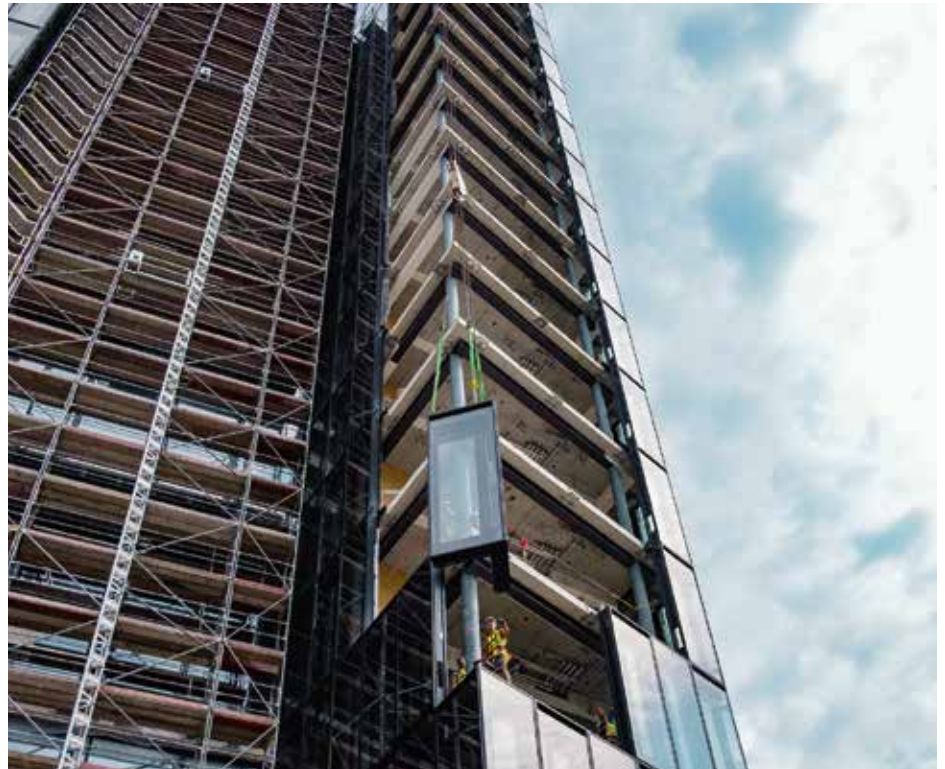
Die Bitzer Firmenzentrale in Sindelfingen: auf 70 m Höhe ausgerüstet mit Trinkwasser-Pressverbindersystemen von Viega.
