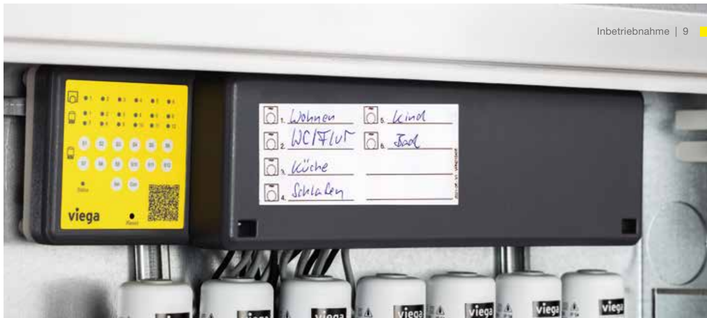
Der Aufkleber dokumentiert die Zuordnung der Heizkreise auch langfristig.
