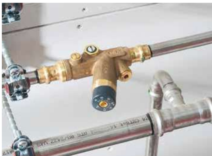
Das Nachrüsten von Zirkulationsreguliertventilen ist förderfähig.
