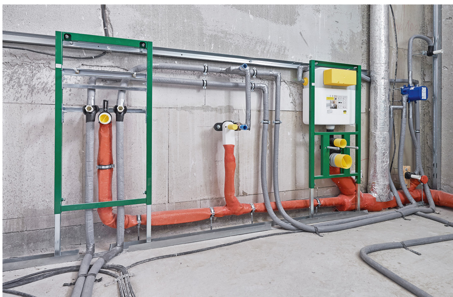
Sämtliche Bauteile in Installationen müssen bestimmungsgemäß der Trinkwasserversorgung dienen.
