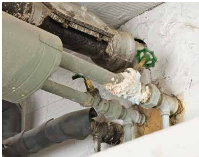
Eine Kontamination des Rohrleitungsnetzes kann bei trinkwasserhygienisch problematischen Betriebsbedingungen prinzipiell überall entstehen, unabhängig von der Leitungslänge. Aber mit größter Wahrscheinlichkeit in Altinstallationen wie dieser ...
