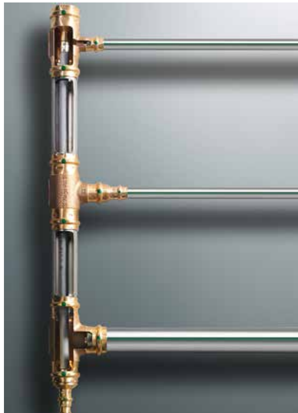
Inliner-Installationen, bei denen PWH-C innerhalb der „Zuleitung“ rückgeführt wird, sorgen für signifikant niedrigere Energieverluste, also auch für eine deutlich geringere Erwärmung der Umgebung – Stichwort: Wärmeübergang auf Kaltwasser führende Trinkwasser-Installationen in Schächten mit Gemischtbelegung.
